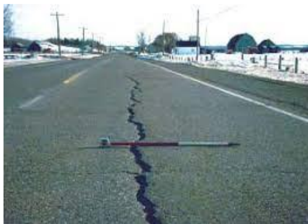
Figure 2-4:Fissures longitudinales hors-piste de roues (MTQ, 2002)
