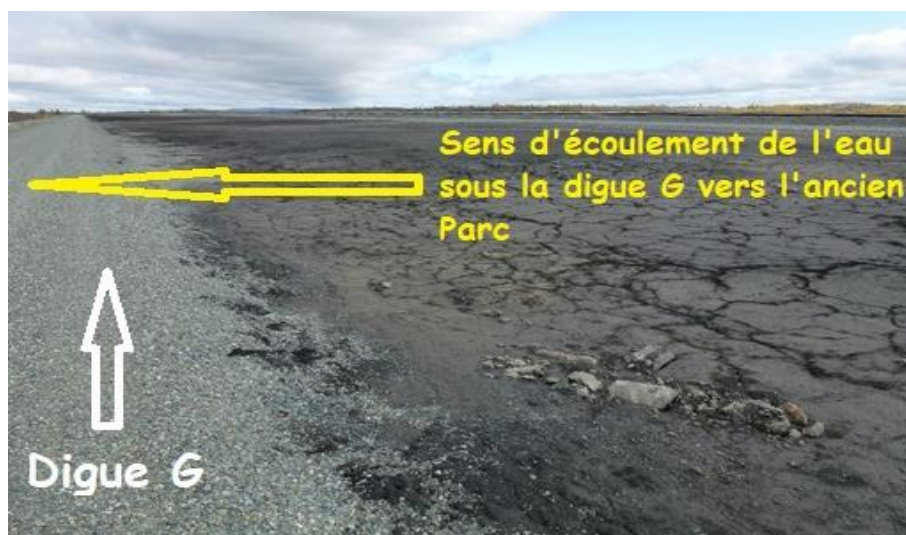
Figure 4.14 Photos de la zone de nouveau parc à l'est de la digue G où l'anomalie physique a été observée (3 octobre 2019)
