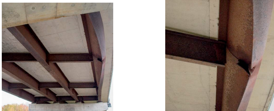
FIGURE 1.1 Déformation et rupture plastique d'une poutre après une collision avec un véhicule survenue à l'Assomption (Québec), Édouard Berton, 2016 [2]
