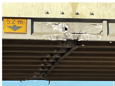
(a) Écaillage du béton, Heidenreich 2025 [22]
