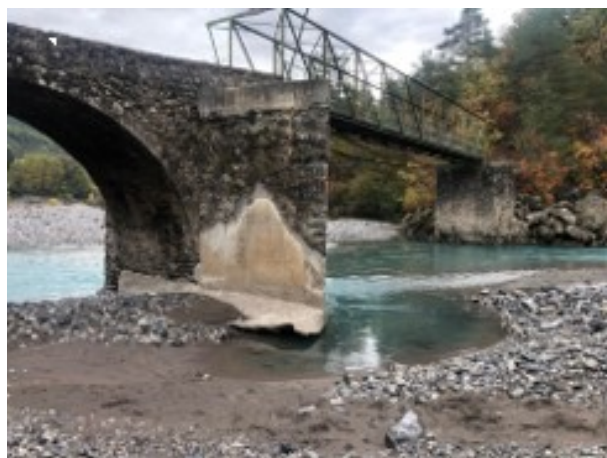
(c) Affouillement d'une pile de pont, Villards sur Var, France, 2020
