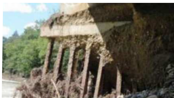
(b) Affouillement du pilier, pont de Dummerston, Vermont, USA, 2014
