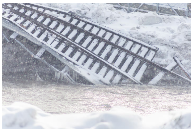
(a) Pont ferroviaire effondré
