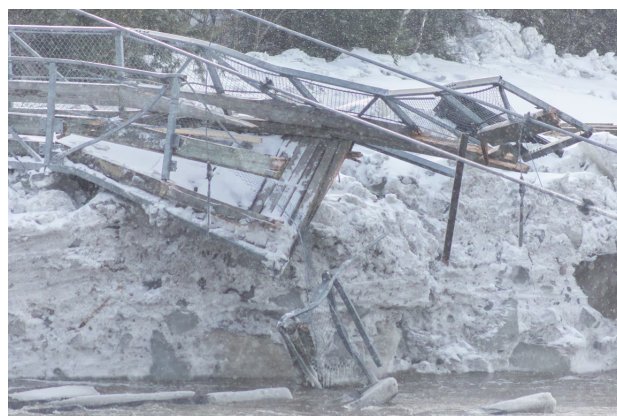
(b) Pont pour motoneigistes, quadistes et cyclistes effondré
