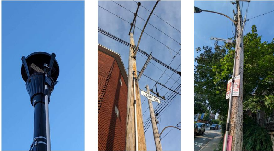
Figure 5-4 : Installation typique des caméras sur poteaux télescopiques
