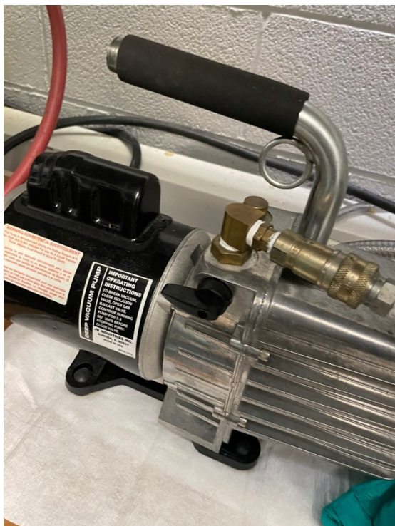
Figure 3.5. Pompe à vide
