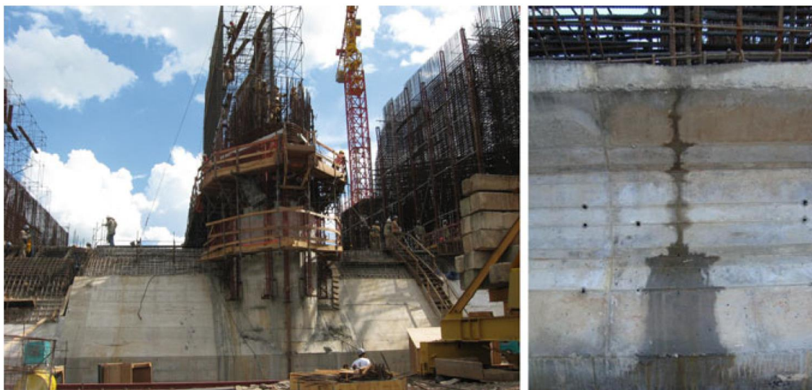
Figure 2-5 : Apparition des fissures dans l'évacuateur de crue d'une centrale hydroélectrique, tiré de (Funahashi and Kuperman 2010).
