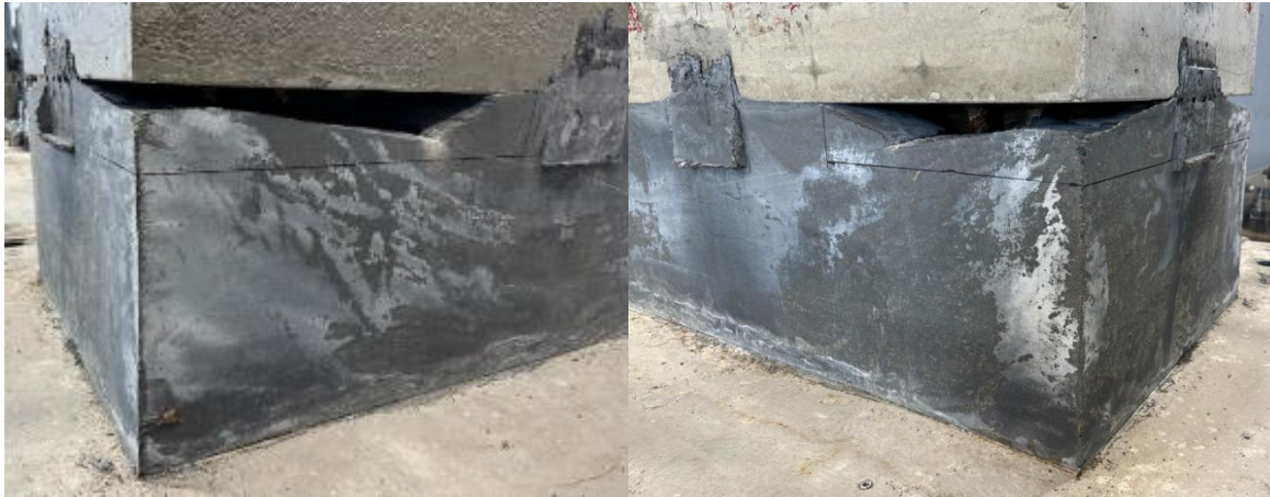
Figure 5.13 Trou d'air dans le joint
