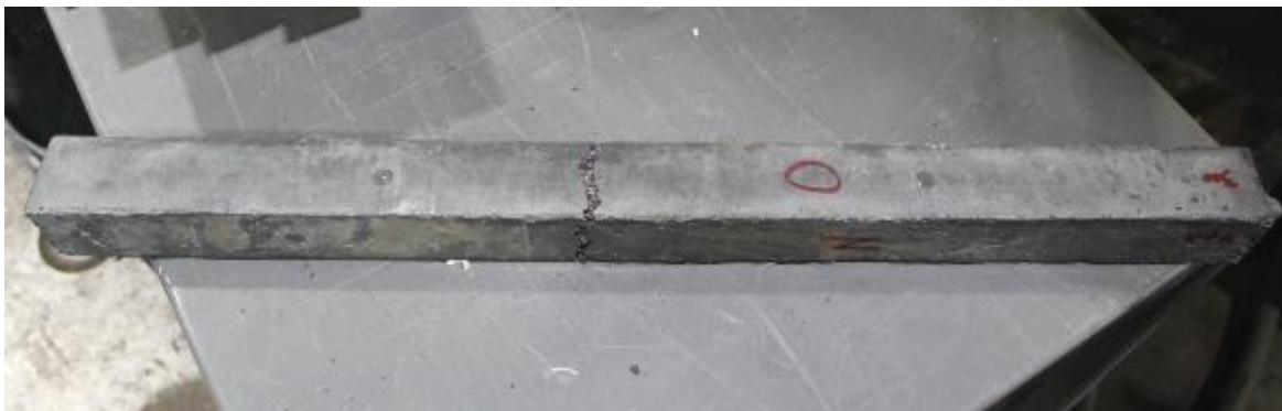
Figure 4.27 Exemple de tirant après essai de traction – fissuration au centre
