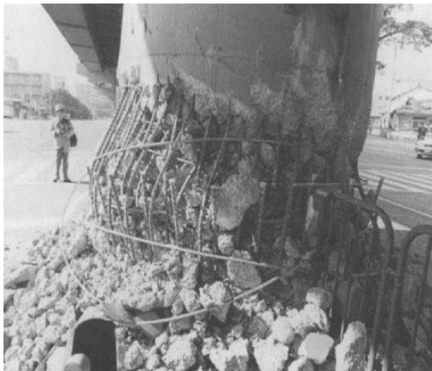
Figure 2.10 Rupture associée flambement des armatures longitudinales (Alim et al., 2015)
