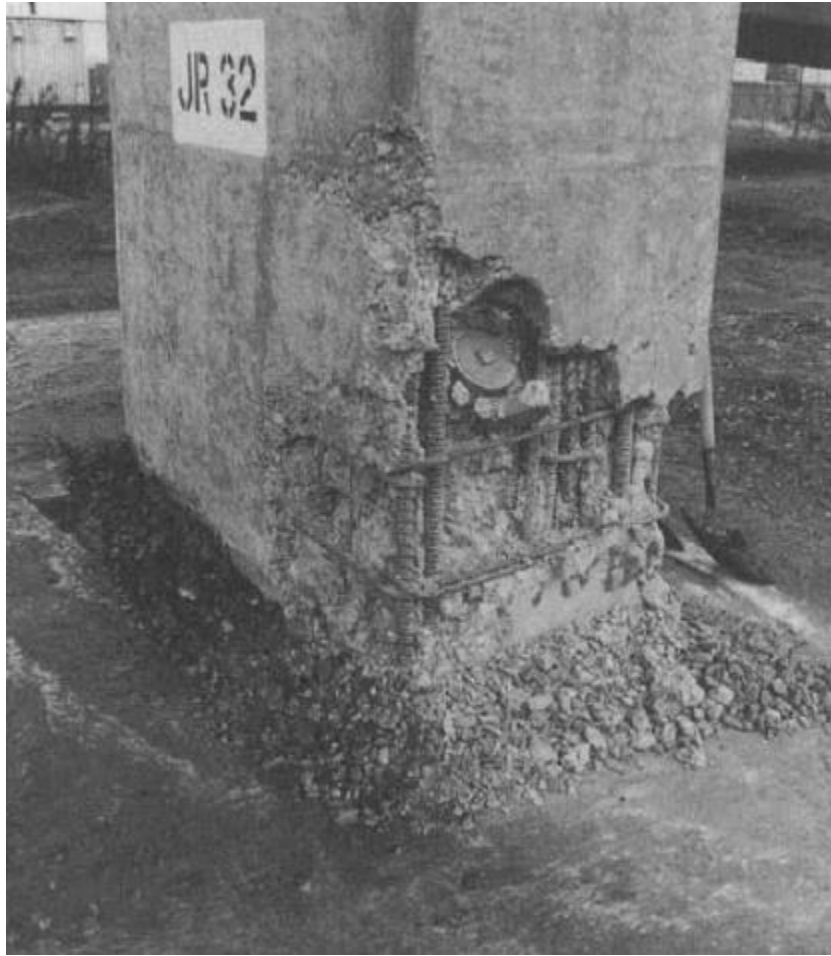
Figure 2.12 Rupture du joint de chevauchement, séisme de Loma Prieta 1989 (Priestley et al., 1996)
