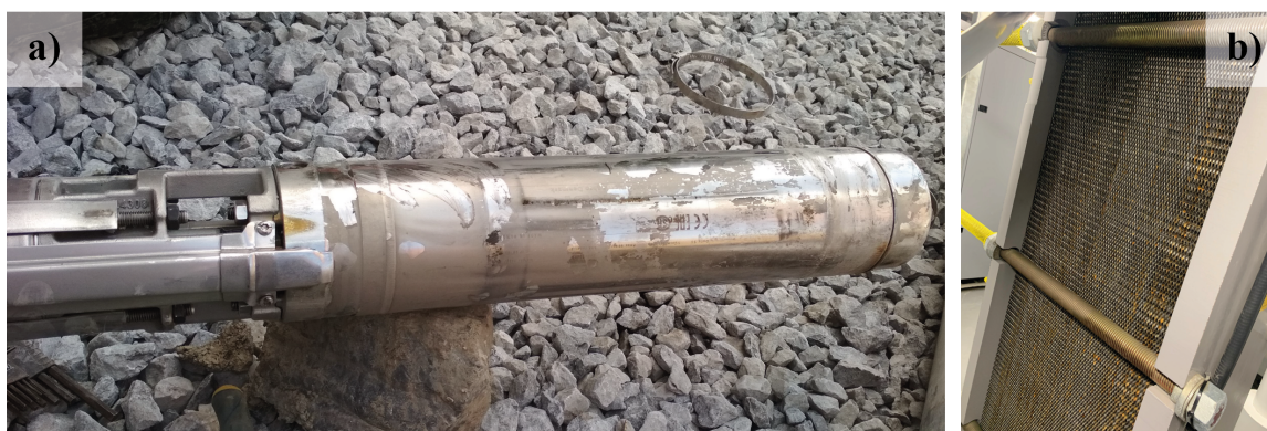
FIGURE 7.2 Développement probable de bactéries du sulfate : a) photo d'une pompe submersible avec un léger développement de biofilm et b) légères traces de corrosion sur l'échangeur à plaque.
