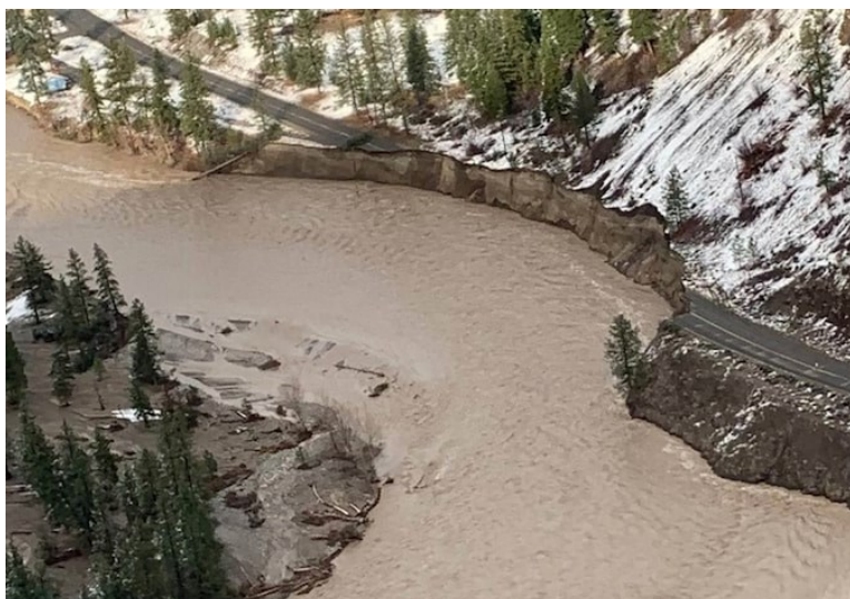
Figure 2.15 – Érosion externe sur les pentes latérales d'une route (Lévesque, 2022)
