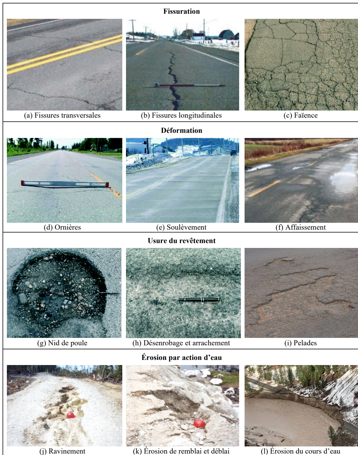
Figure 2.17 – Exemples de dégradations de chaussées (Hassan, 2015; LCPC, 1998; MTQ, 2002)
