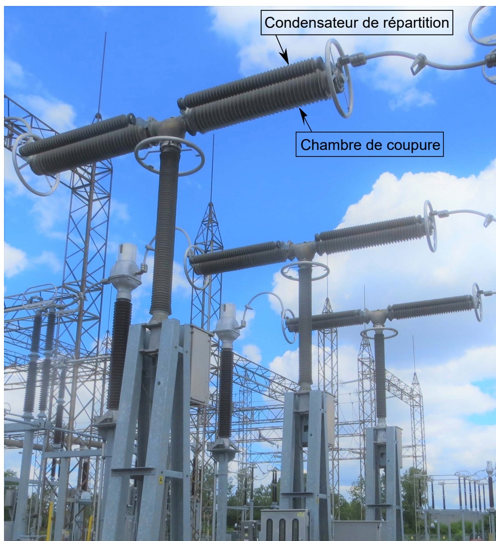
FIGURE 1.2 Trois pôles de disjoncteurs à gaz SF 6 munis chacun de deux chambres de coupure et de deux condensateurs de répartition
