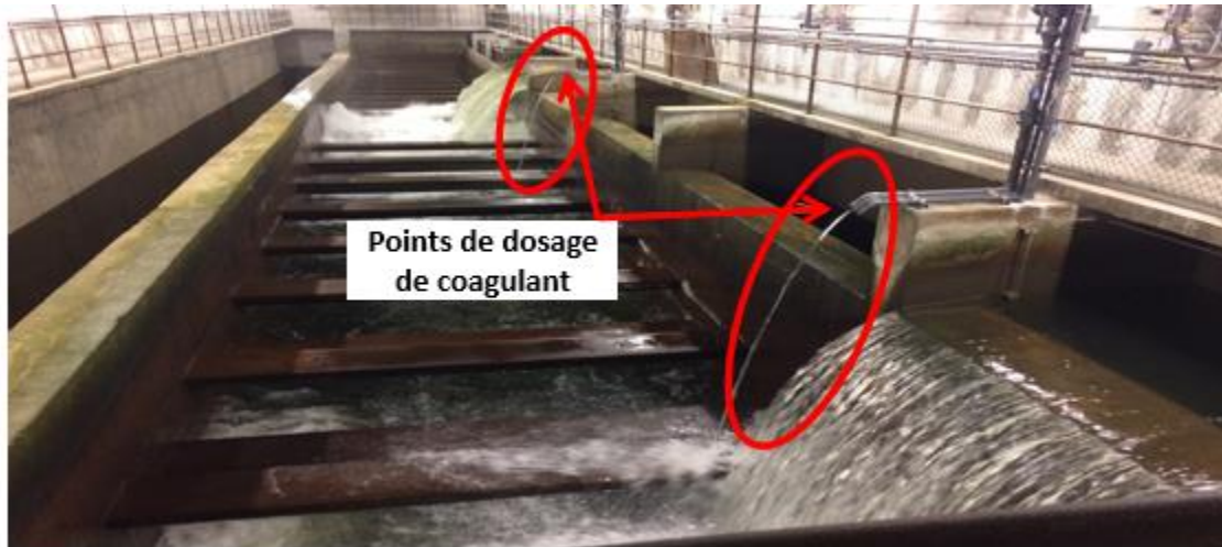
Figure 3.4 Points d'injection de coagulant à l'usine.
