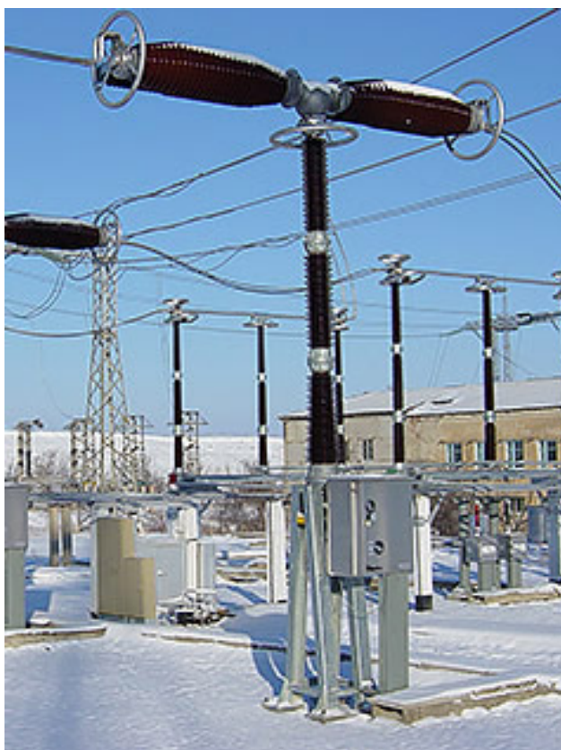
Figure 1.1 Exemple de disjoncteur (disjoncteur à réservoir vivant) installé sur site. Source : https://www.gegridsolutions.com/HVMV_Equipment/catalog/LiveTank_CircuitBreakers.htm
