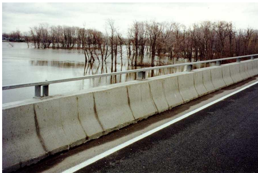
Figure 1.1 - Fissures verticales 7 mois après la reconstruction du parpaet sur le pont Vachon (A-13, Laval, QC) (Cusson & Repette, 2000)
