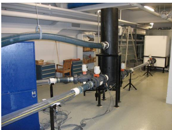
Figure 4-10 : Photo du modèle installé
