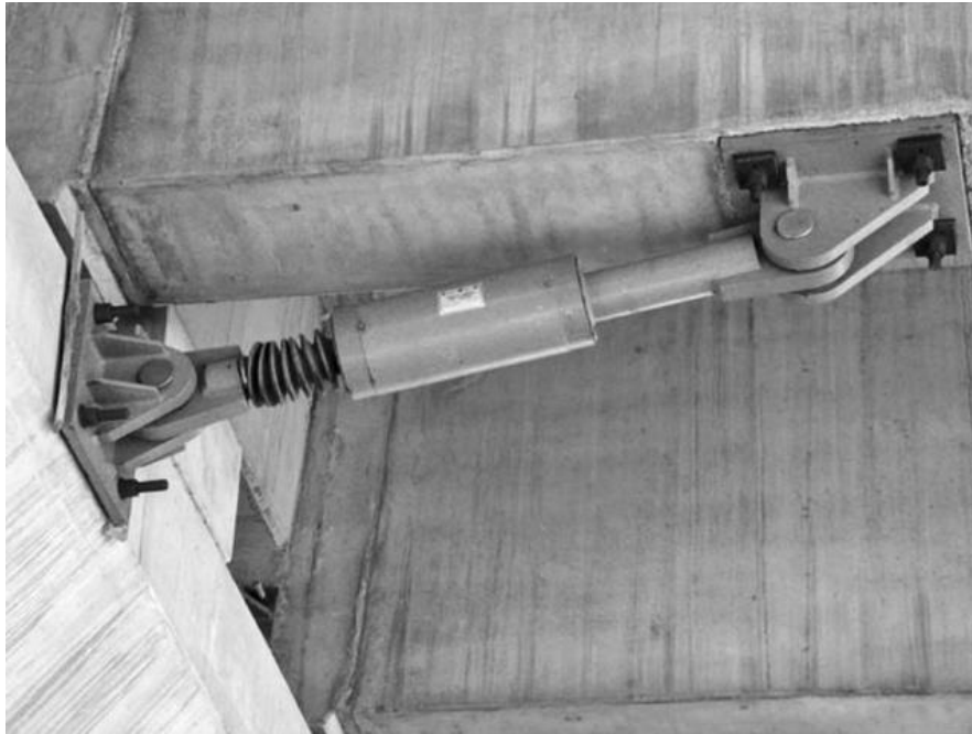
Figure 2.4: Amortisseur visqueux installé sur un pont (tiré de Filiatrault, 2013)
