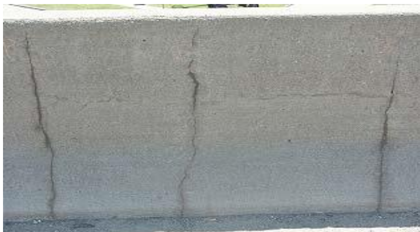
Figure 2-13: Fissuration verticale fréquemment observées sur les parapets coulés en place (Haluk et al., 2004)
