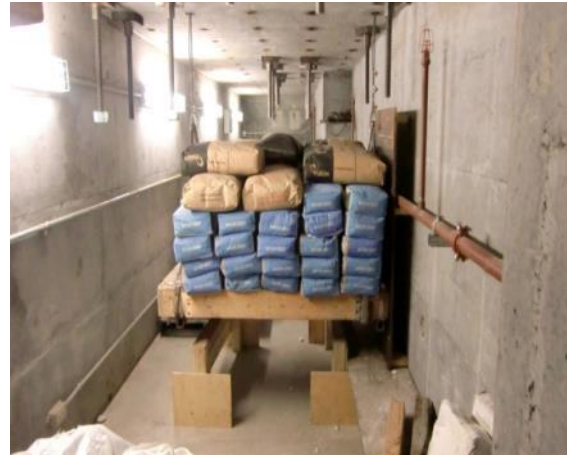
b) Contrepoids au sous-sol
