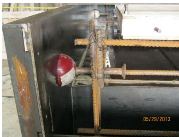
b) Après installation
