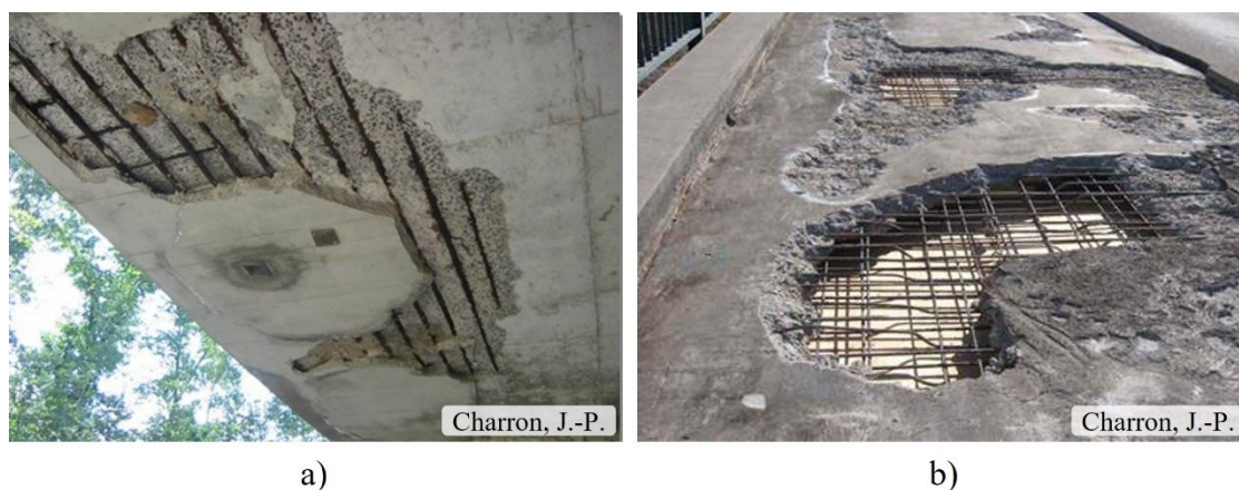
Figure 1-1 Exemple de détérioration de dalles de ponts, a) dessous de dalle, b) dessus de dalle en cours de réparation
