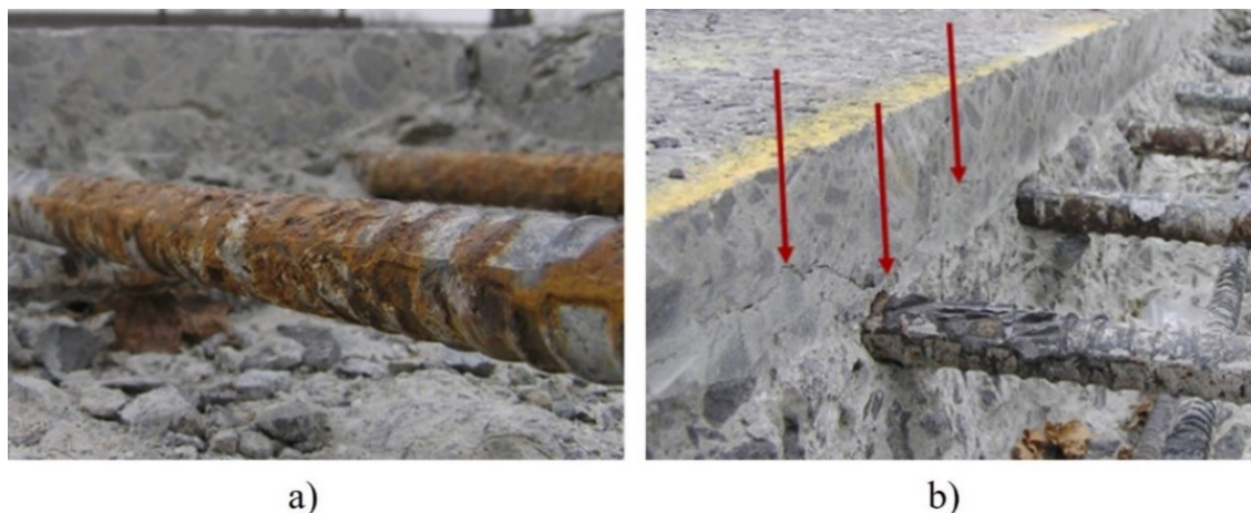
Figure 1-2 Degradations observées sur les tabliers de ponts, a) corrosion des armatures, b) délamination d'une couche de béton, (Gucunski et al., 2013)
