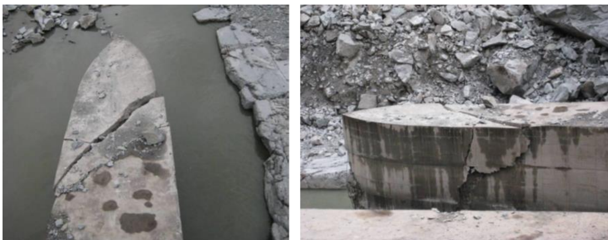
Figure 2.6 Endommagement d'un pilier à cause de chutes de roc lors du séisme de Wenchuan (Chine, 2008) (Wieland, 2012)
