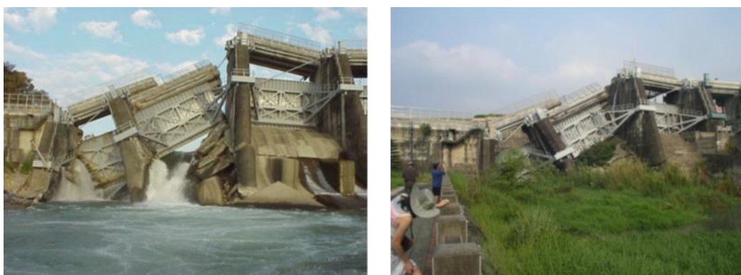
Figure 2.2 Effondrement des piliers n° 1,2 et 3 de de l'évacuateur de crues Shih Kang à la suite du séisme (Charlwood et al., 2000)
