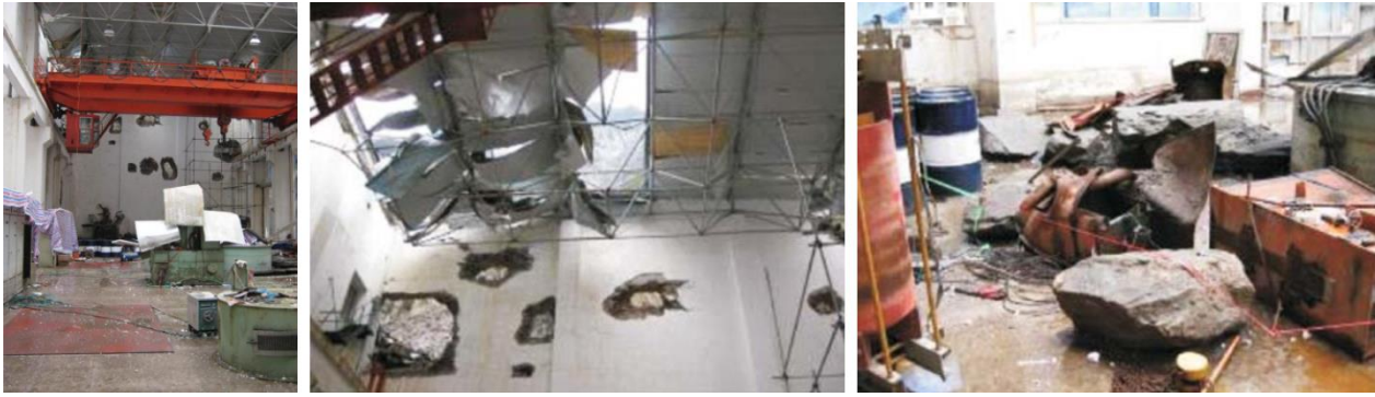
Figure 2.4 Séisme de Wenchuan (Chine) – mai 2008 : (a) et (b) Mur et Plafond du bâtiment de contrôle endommagés par la chute des blocs au barrage Shapai; (b) équipements électromécaniques endommagés par les blocs (Photo : M. Weiland).
