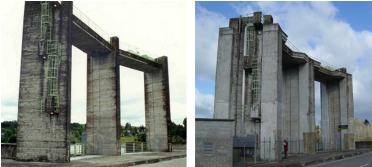
Figure 2.5 Renforcement des piliers de l'évacuateur de crue du barrage-poids Whakamura à Nouvelle-Zélande (à gauche : Conception initiale de la structure avec un coefficient sismique de 0.1g, à droite : structure renforcée avec un coefficient sismique de 1.9g) (Foster and Black, 2003).
