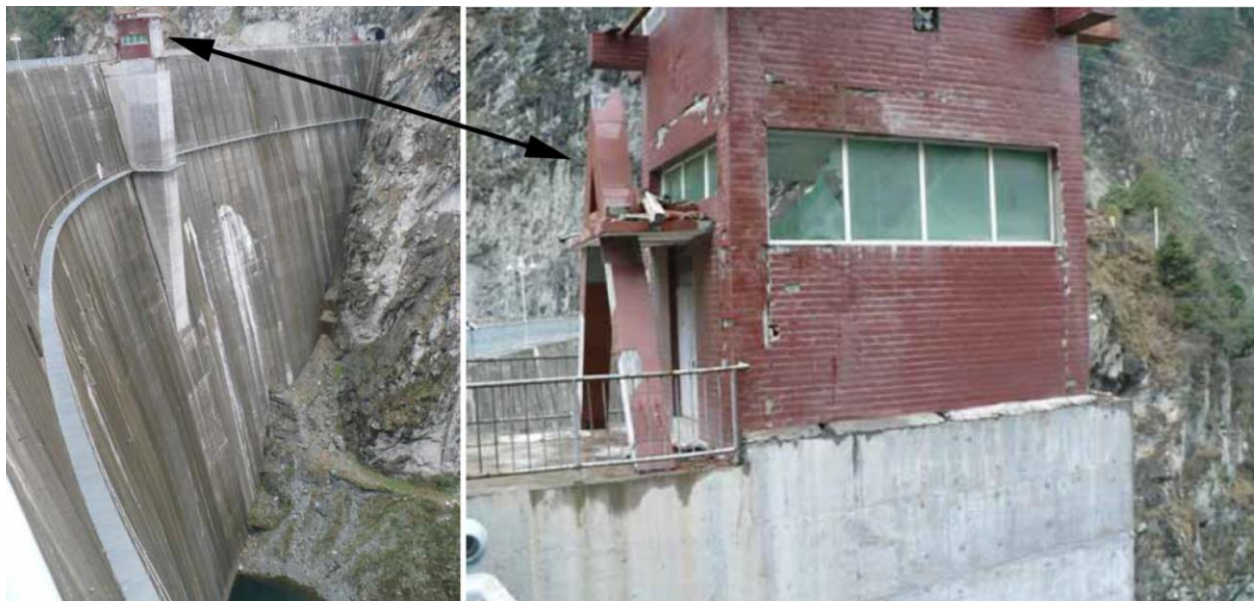
Figure 2.2 Séisme de Wenchuan (Chine) – mai 2008: Dommages subis par le bâtiment de la cage d’ascenseur a la crête du barrage de Shapai, adaptée de (USSD, 2014).
